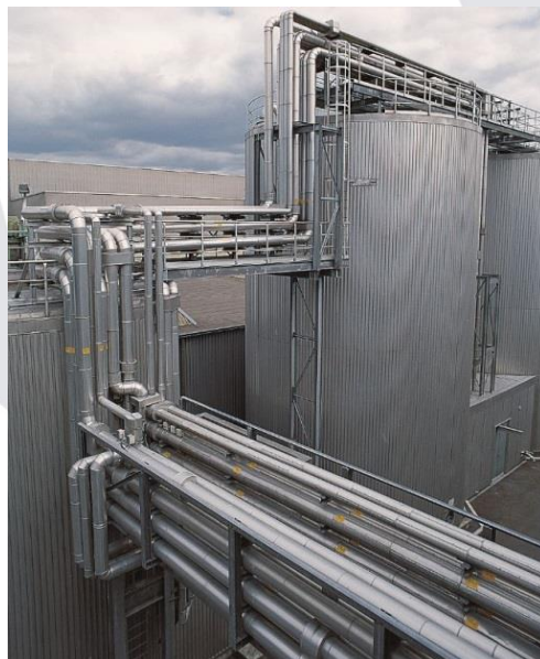
Isolierte Versorgungsrohrleitungen, Werkstoff 1.4571 für eine Pigmentaufbereitung
