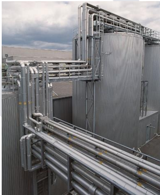
Isolierte Versorgungsrohrleitung für eine Pigmentaufbereitung, Werkstoff 1.4571
