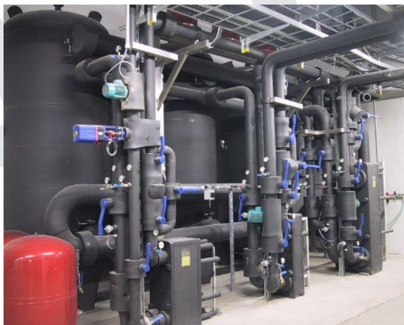
Kälteversorgung für eine Streichmaschine
