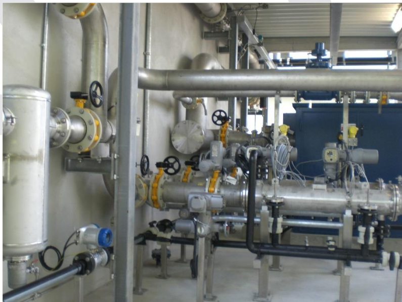
Teilbereich einer anaeroben Abwasserreinigungsanlage Rohrleitungs-Werkstoff: 1.4571
