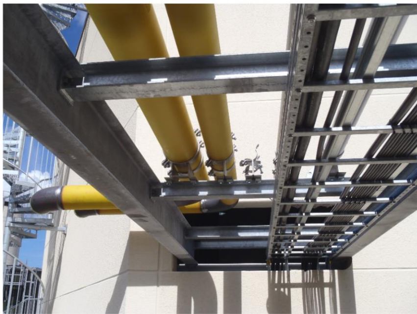
Gasversorgung DN 150, Gasleitung 4 bar für ein BHKW
