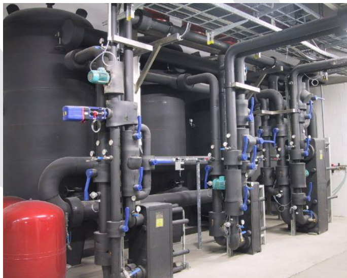
Kälteversorgung für eine Streichmaschine
